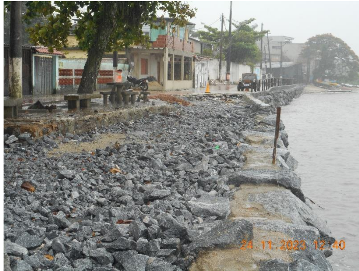
Foto 8: Vista para norte do final do trecho em recuperação. Ao fundo o segmento já recuperado.
